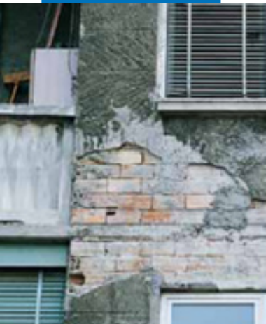
Рузрушающийся фасад здания, требующий ремонта
