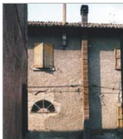
Рис. 5.3 Стена с поднимающейся влагой
