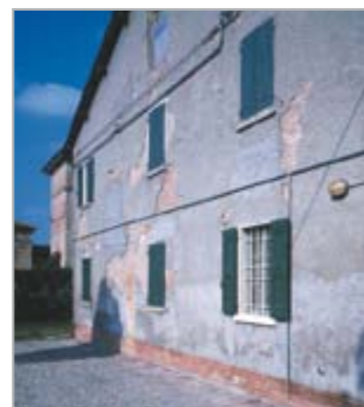
Рис. 5.4 Отваливающиеся куски штукатурки следует удалить и отремонтировать поверхность, перед тем как приклеивать изоляционную панель
